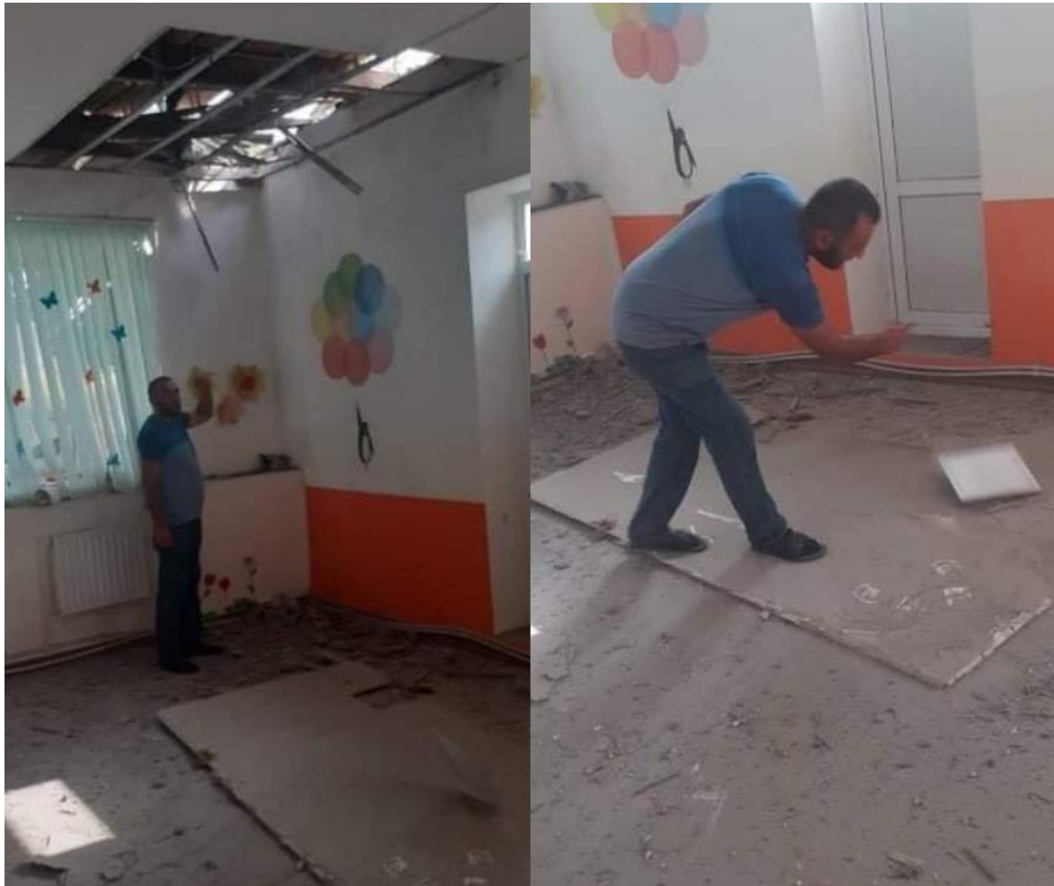
Beschossener Kindergarten in der Gemeinde Aygepar, Quelle: aysor.am
